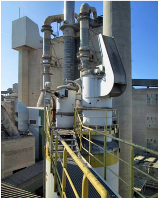
Bild 4: Abscheider mit Druckentlastungsklappe auf Pufferbehälter
