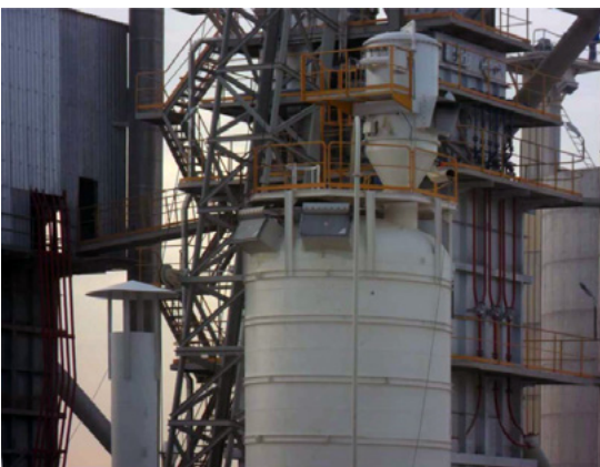
Bild 5: Silobefüllung über Zyklonabscheider (mit seitlicher Explosionsdruckentlastung)
