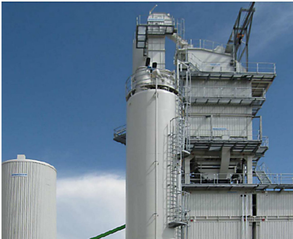
Bild 3: Außensilo mit verfahrenstechnischer Prozessanlage
