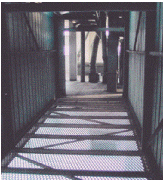
Bild 39: Übergang mit Gitterboden.
