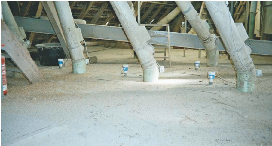
Bild 2: Beispiel für „schlechte“ Reinhaltung auf dem Siloboden, daher Zone 22 (Markierung nicht mehr sichtbar)
