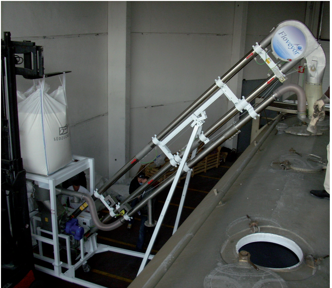
Figure 10: Use of an aeromechanical conveyor to charge a mobile silo (Source: Gough GmbH Sieb- und Fördertechnik)
